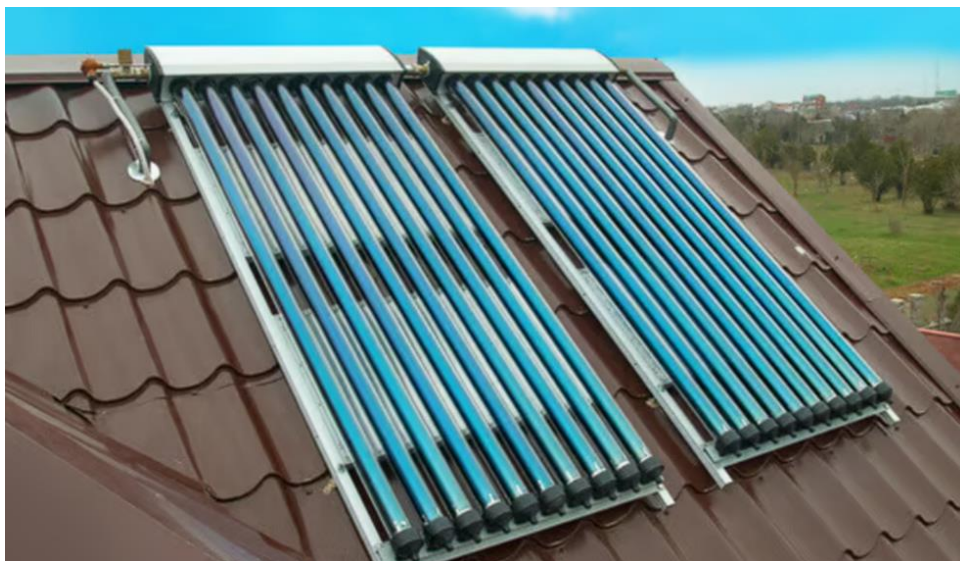
Figura 1. Colector solar. Fuente: GreenMatch
